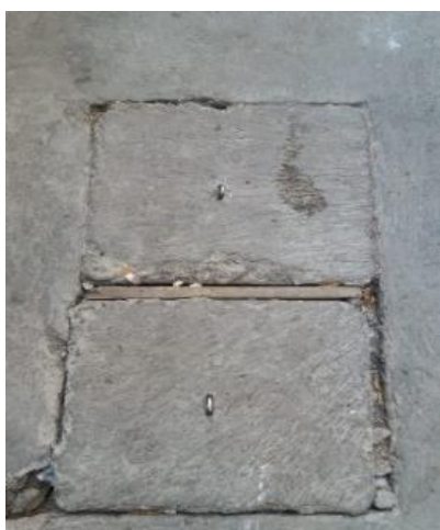
Gambar 1 Kondisi manhole IPAL komunal di RT 2 RW 12 Kelurahan Bendul Merisi Kota Surabaya
