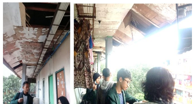
Gambar 6. Beberapa kerusakan elemen bangunan Rusunawa Warugunung (Sumber: Dokumentasi Survei, 2018)
